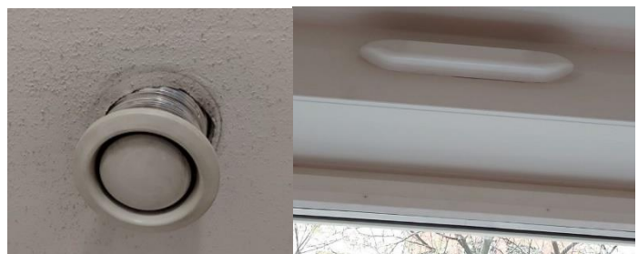
Bouches d'extraction et entrée d'air à la maison de l'enfance (VMC simple flux)
