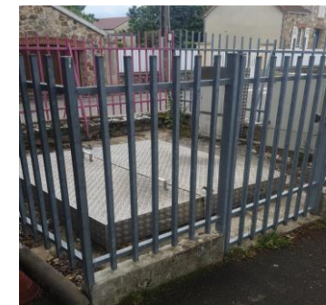
Pompe de relevage
